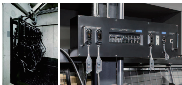
移動型調光器（写真左）と、その電源になる単相3線電源ユニットボックス（写真右）をホール内に分散配置し、各所の負荷設備側で調光回路と直回路を選択できるようにしている。
